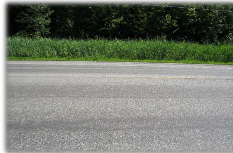
Figure 7 — Marquage au sol effacé et présence d'importantes roulières
